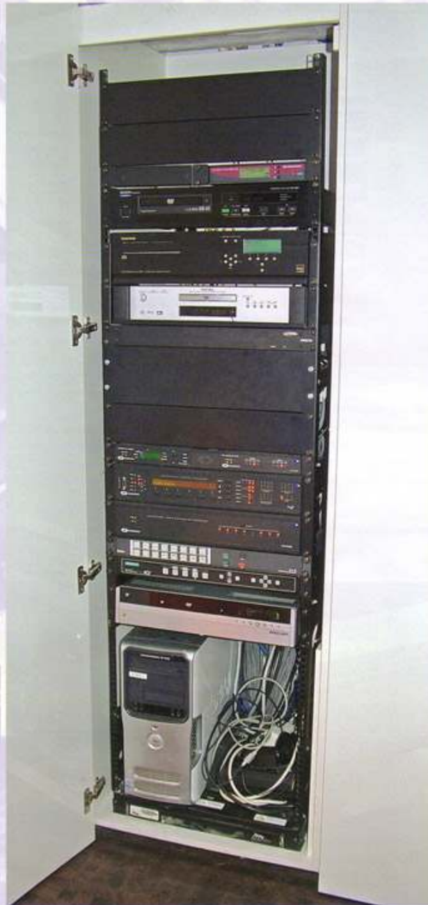
Onderstation voor de datasystemen van een domotica-installatie.
